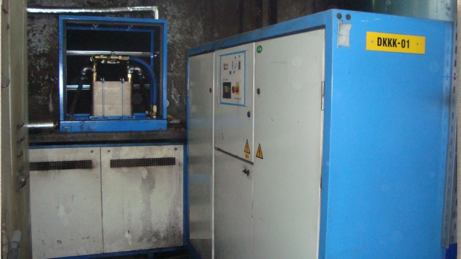
Fotoğraf 1 :Ay Döküm AŞ. Kompresör Odası – Kompresör ve Eşanjör
