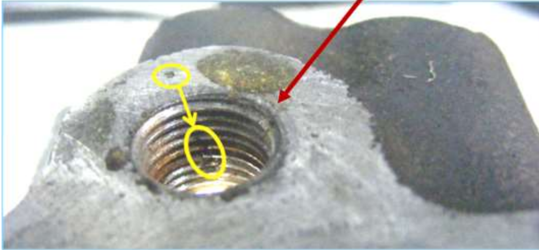
Sızdırma bölgesinin tespit görüntüsü
